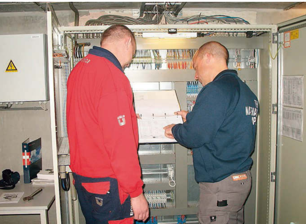
Monteurs van Unica en The Maintenance Company bestuderen de documentatie van een installatie.
